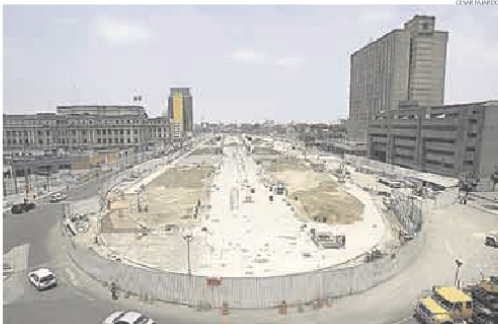
► HISTORIA SIN FIN. Cronograma de construcción del Metropolitano se halla en “ruta crítica” por los retrasos.
